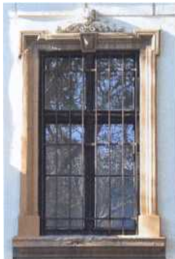
Ebner köz felőli oldal ablaka
